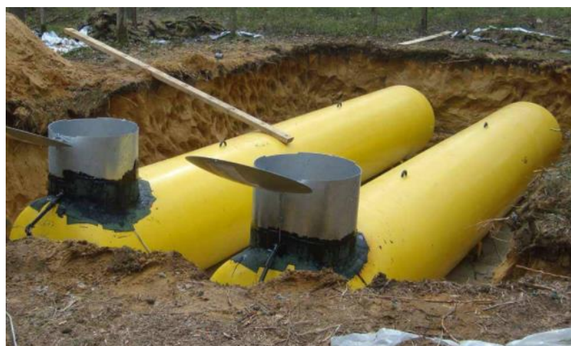
Рисунок 4. Ошибка при гидроизоляции стыков
