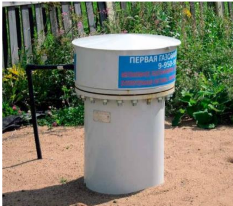
Рисунок 6. Ошибка в прокладке подводящего газопровода
